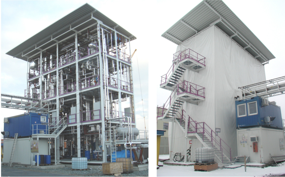
Abbildung 6: 1MW BioSNG Pilot- und Versuchsanlage
